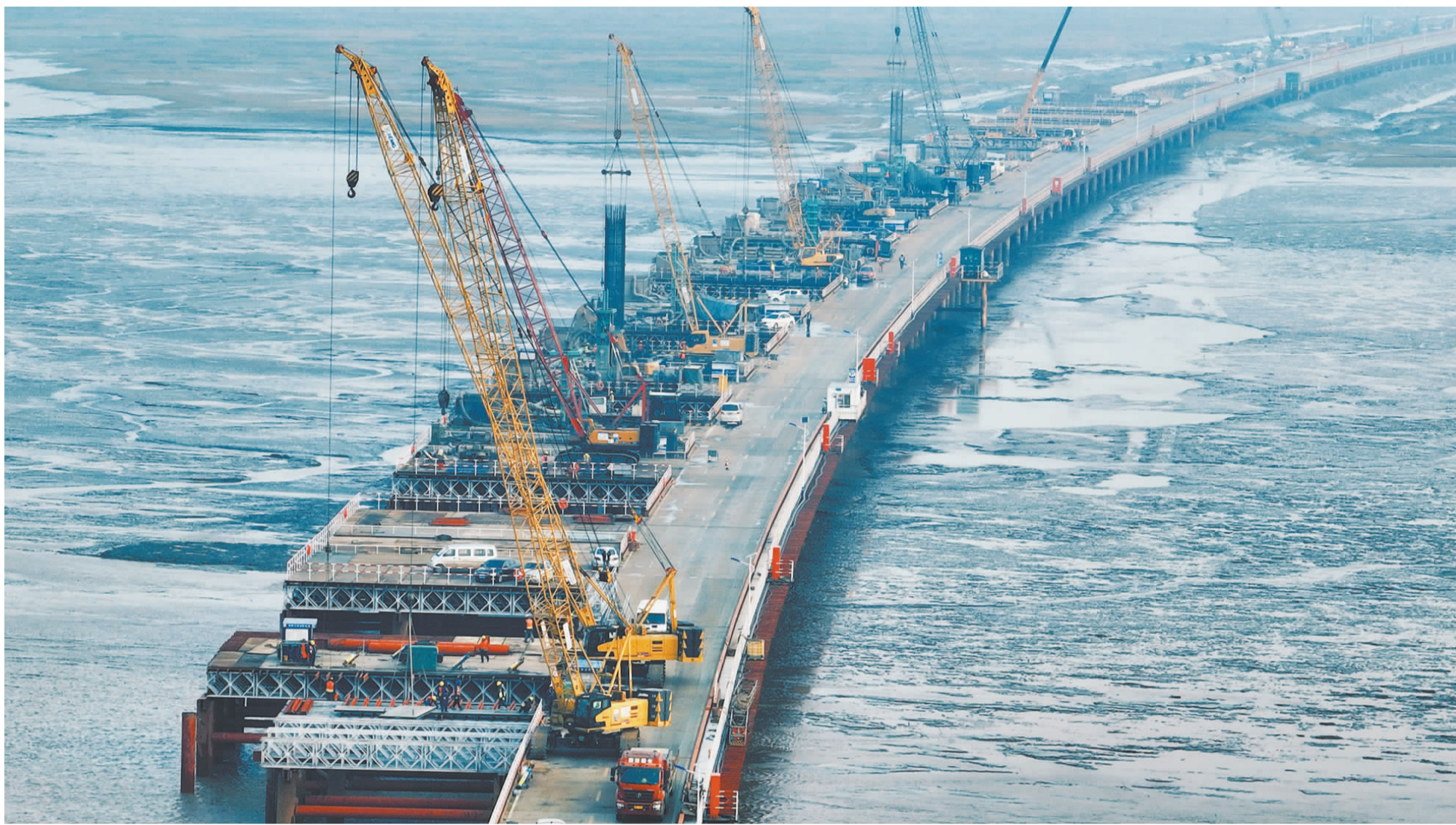
通苏嘉甬高铁杭州湾跨海铁路大桥项目栈桥与材料周转平台完成建设
