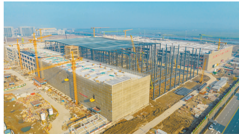
方太高端厨电智造创新产业园项目主体结构施工进度超50%
