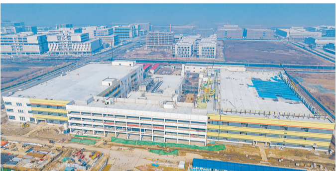
半导体光电和功率器件IDM项目室内装修和机电安装进度过半
