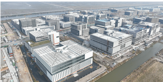
战略新兴产业园B地块建设收尾，A地块与D/E地块（一期）主体结构封顶
